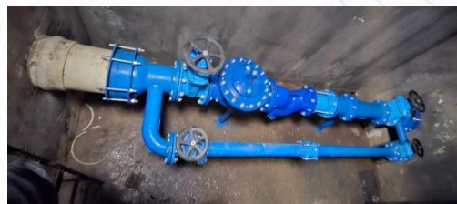
11 Cámaras de Control Hidráulico
