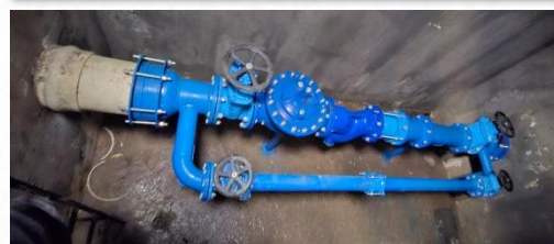
11 Cámaras de Control Hidráulico
